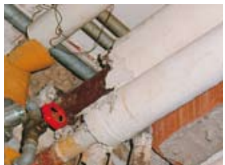
Asbesthaltiger Mörtel zur Rohrisolation
