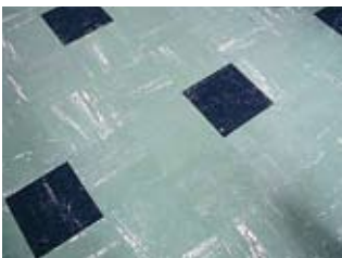
Asbesthaltiger Bodenbelag (Quelle: IST)
