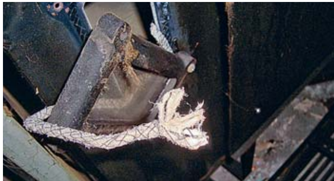
Asbestschnur als Dichtung an einer Anlage
