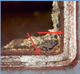
Isolationsband an Heizkessel
