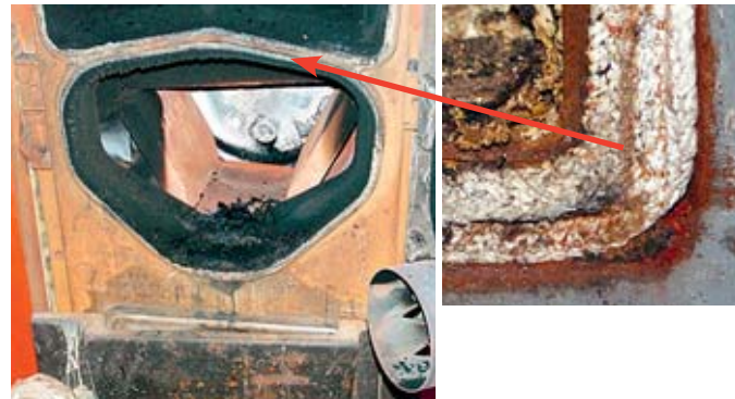
Asbestschnur an Heizkessel
