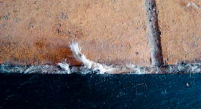
Asbestschnüre in einem Cheminée
