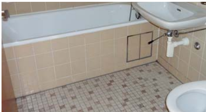
Platten mit asbesthaltigem Kleber
