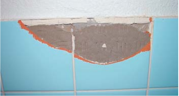
<1% Chrysotil-Asbest im Kleber
