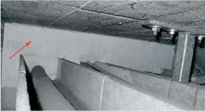
Kabeldurchbruch mit Brandabschottung
