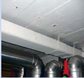
Kabelkanal aus Asbestzement
