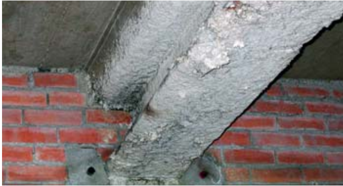
Spritzasbest an Stahlträger
