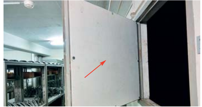
Brandschutz an Türe
