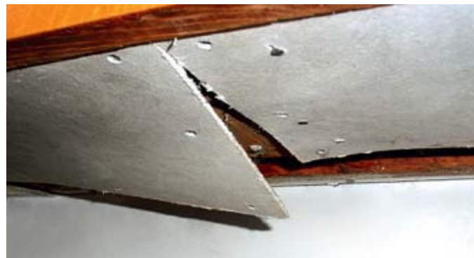
Asbesthaltige Leichtbauplatten als Brandschutz
