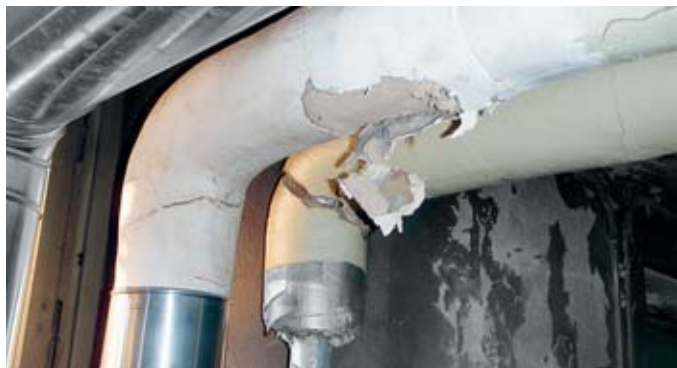
Rohrleitung mit asbesthaltigem Mörtel
