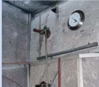
Lüftungsanlage aus Asbestzement
