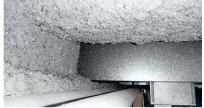
Spritzasbest als Brandschutz an Metallträger
