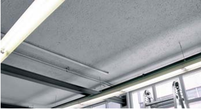
Spritzasbestbelag an Decke
