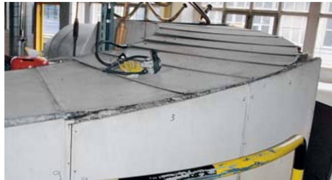
Asbesthaltige Dämmung hinter einer Verkleidung
