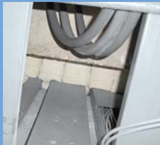
Brandabschottung mit Asbestkissen
