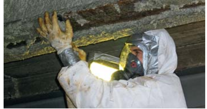
Entfernen nur durch anerkanntes Asbestsanierungsunternehmen
