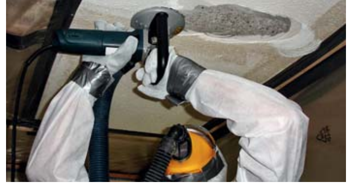
Entfernen nur durch anerkanntes Asbestsanierungsunternehmen
