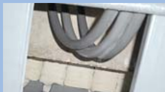
Brandabschottung mit Asbestkissen
