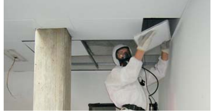
Entfernen nur durch anerkanntes Asbestsanierungsunternehmen
