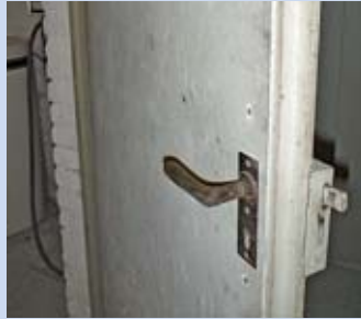
Brandschutztüre mit Asbestzement
