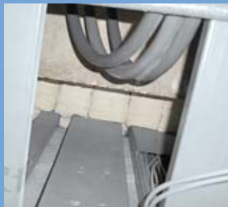
Brandabschottung mit Asbestkissen
