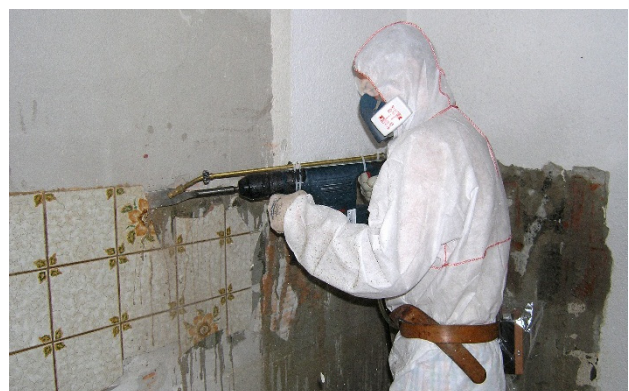
1 Platten mit asbesthaltigem Kleber müssen mit einem Kangohammer mit Wassersprührichtung nass entfernt werden.
