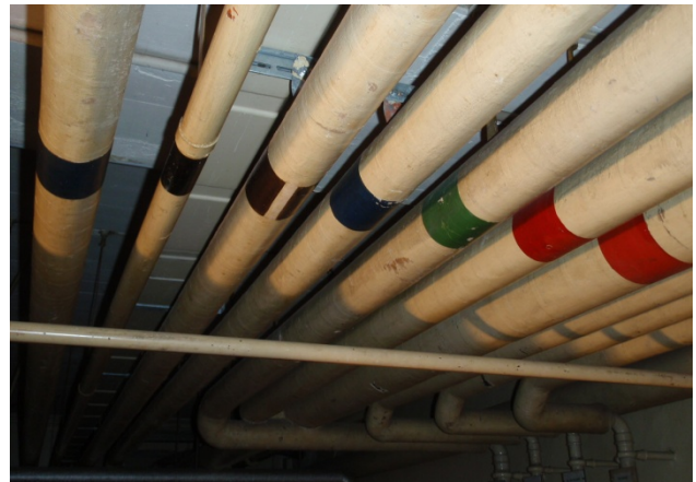
1 Rohrisolation mit asbesthaltiger Gipsbandage
