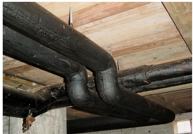
1 Diese Isolation mit bituminösem Anstrich lässt sich mit dem Cutter leicht aufschneiden und entfernen.
