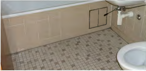
Platten an Boden und Wänden mit asbesthaltigem Kleber
