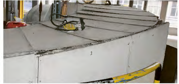
Asbesthaltige Dämmung hinter einer Verkleidung
