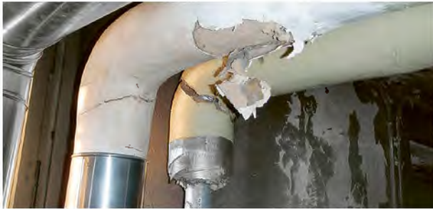
Rohrleitung mit asbesthaltigem Mörtel
