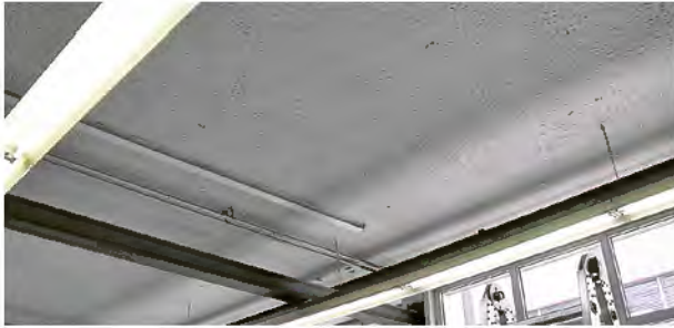
Spritzasbestbelag an Decke
