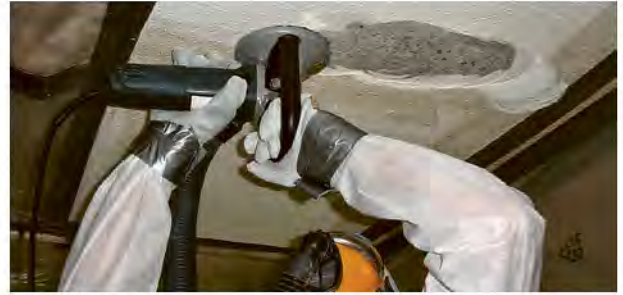
Entfernen nur durch ein anerkanntes Asbestsanierungsunternehmen
