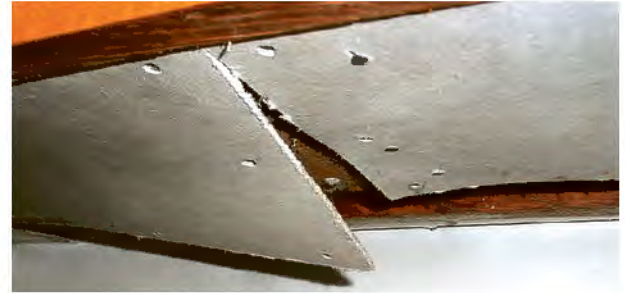
Asbesthaltige Leichtbauplatten als Brandschutz
