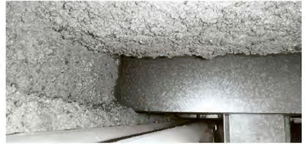
Spritzasbest als Brandschutz an Metallträger
