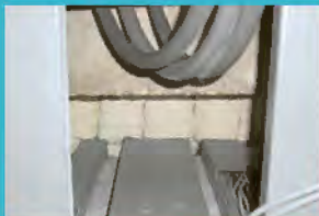
Brandabschottung mit Asbestkissen
