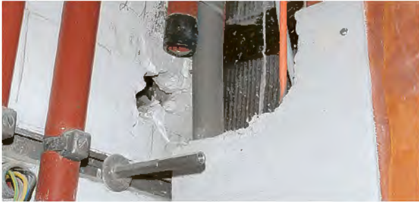
Brandschutzplatte in Steigzone
