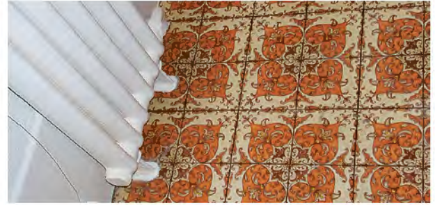
Typisches Muster eines mehrschichtigen asbesthaltigen Bodenbelags
