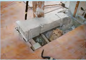
Lüftungskanal aus Asbestzement
