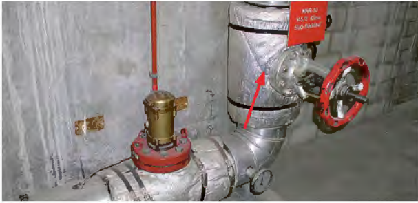
Isolationsschale für die Hitzeisolation
