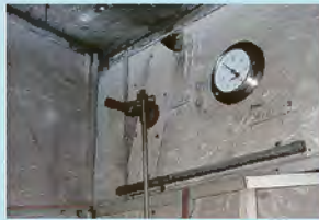
Lüftungsanlage aus Asbestzement
