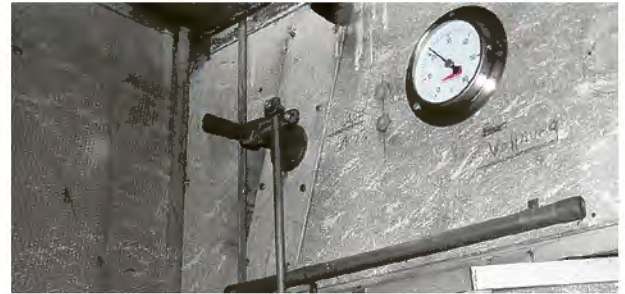
Lüftungskanal aus Asbestzementplatten
