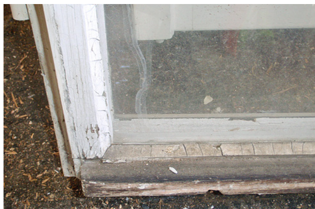
1 Asbesthaltiger Leinölkitt an einem Holzfenster
